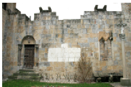
Fig. 29.- Restos de San Nicolás en el cierre del muro del patio. Cámara de Comptos de Pamplona.
