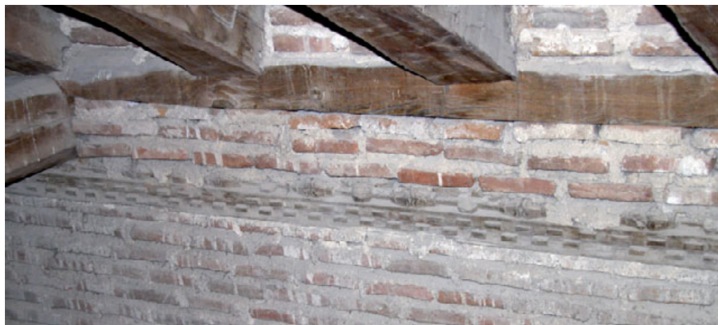
Restos de armadura sobre la nave sur
