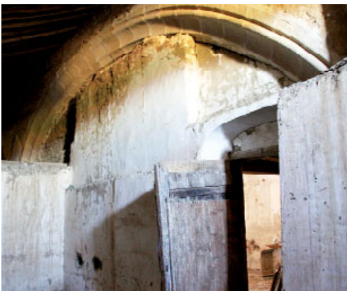
Formero cegado de la nave norte
