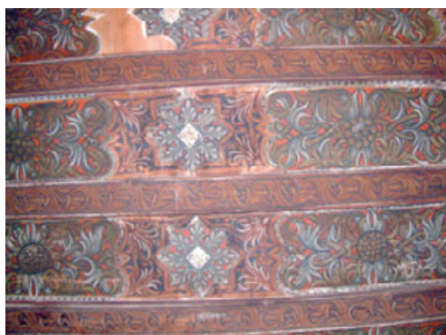
Detalle de la pintura de la armadura entre la cubierta y las yeserías en Fuente el Sáuz
